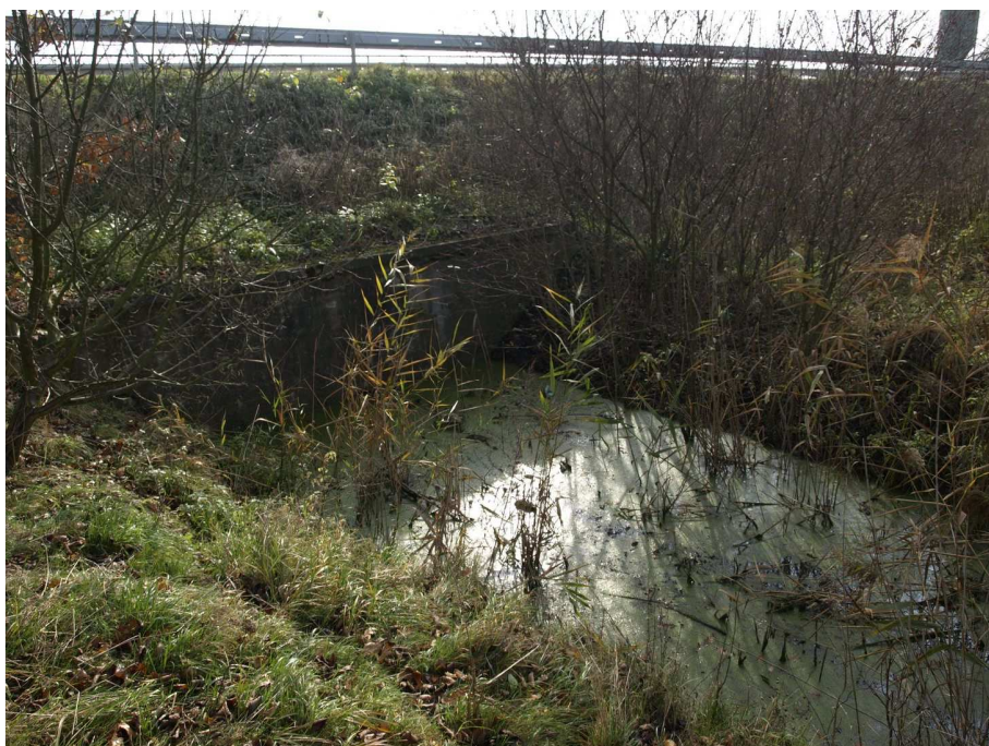
Vyústění odpadního potrubí DN800 od B.P.
